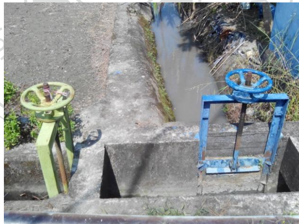
圖 3-4 小給水路閘門，平日須由農民依靠人力自行開關維護
