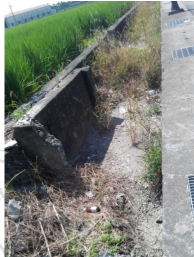
圖 3-3 疏於清理雜草導致水流不通
