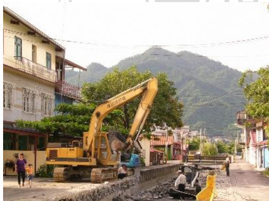
圖 4-6a 水圳改造工程破壞原本空間做起直立水泥護岸圖
